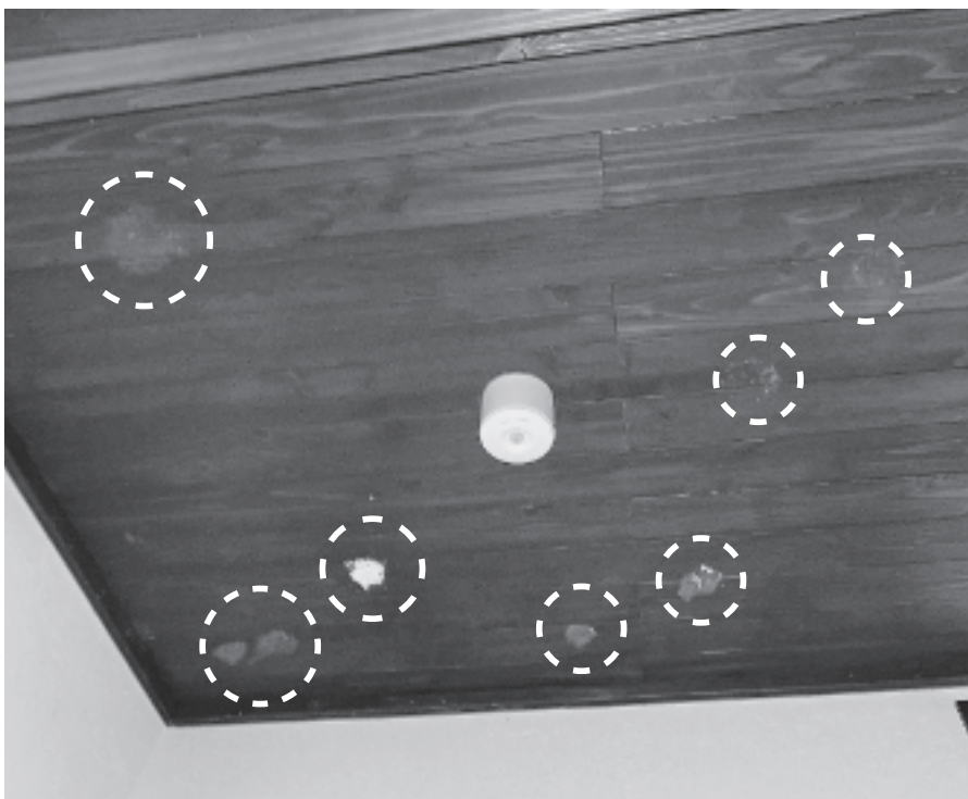
▲天井に貼り付けられたトイレトーパーとその跡
