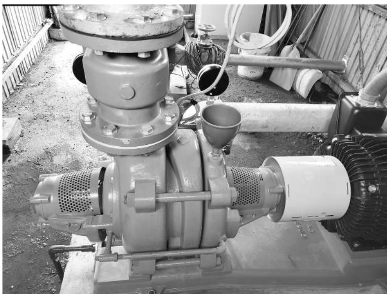
改修された新型の送水ポンプ（東向原）。
