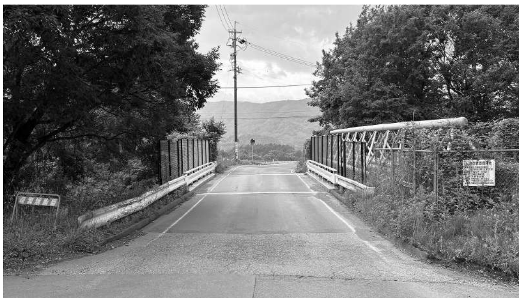
雨水排水対策が待たれる向原橋。
