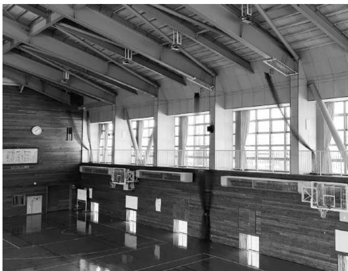
今夏には間に合わないが16基設置予定の中学校体育館ギャラリー。
