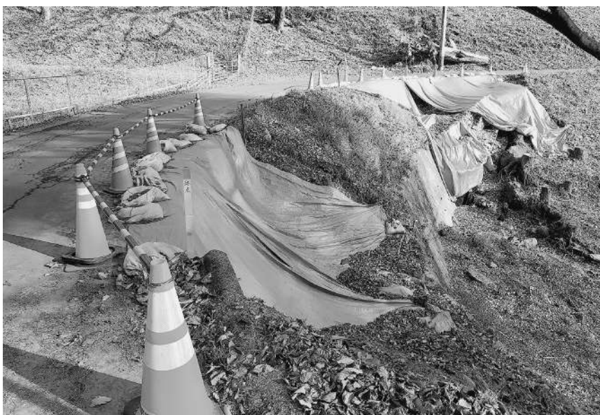
8月7日豪雨で路肩が崩れた町道。
