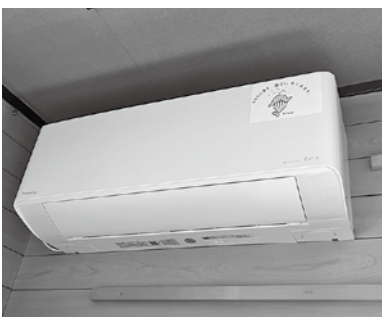
▲荒町区(エアコン)
