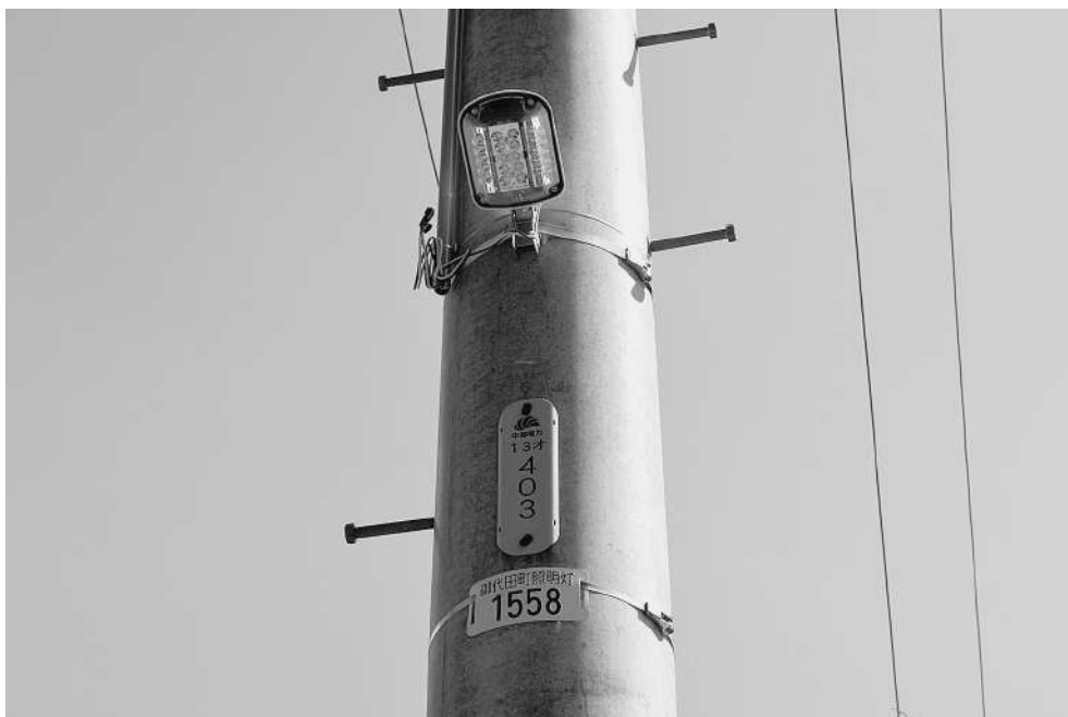
LED化が完了し、電気料が大幅に削減された。
