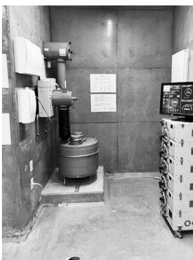
非常時に2週間安全が確保される核(防災)シェルターの設備。
