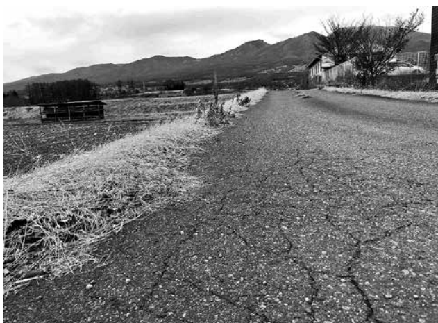
狭い道路は傷みが早い。
