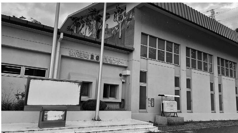
老朽化により施設の建て替えを検討する。
