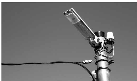
防犯灯の設置によって子どもの安全が守られる
