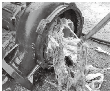
ポンプに詰まった繊維物
